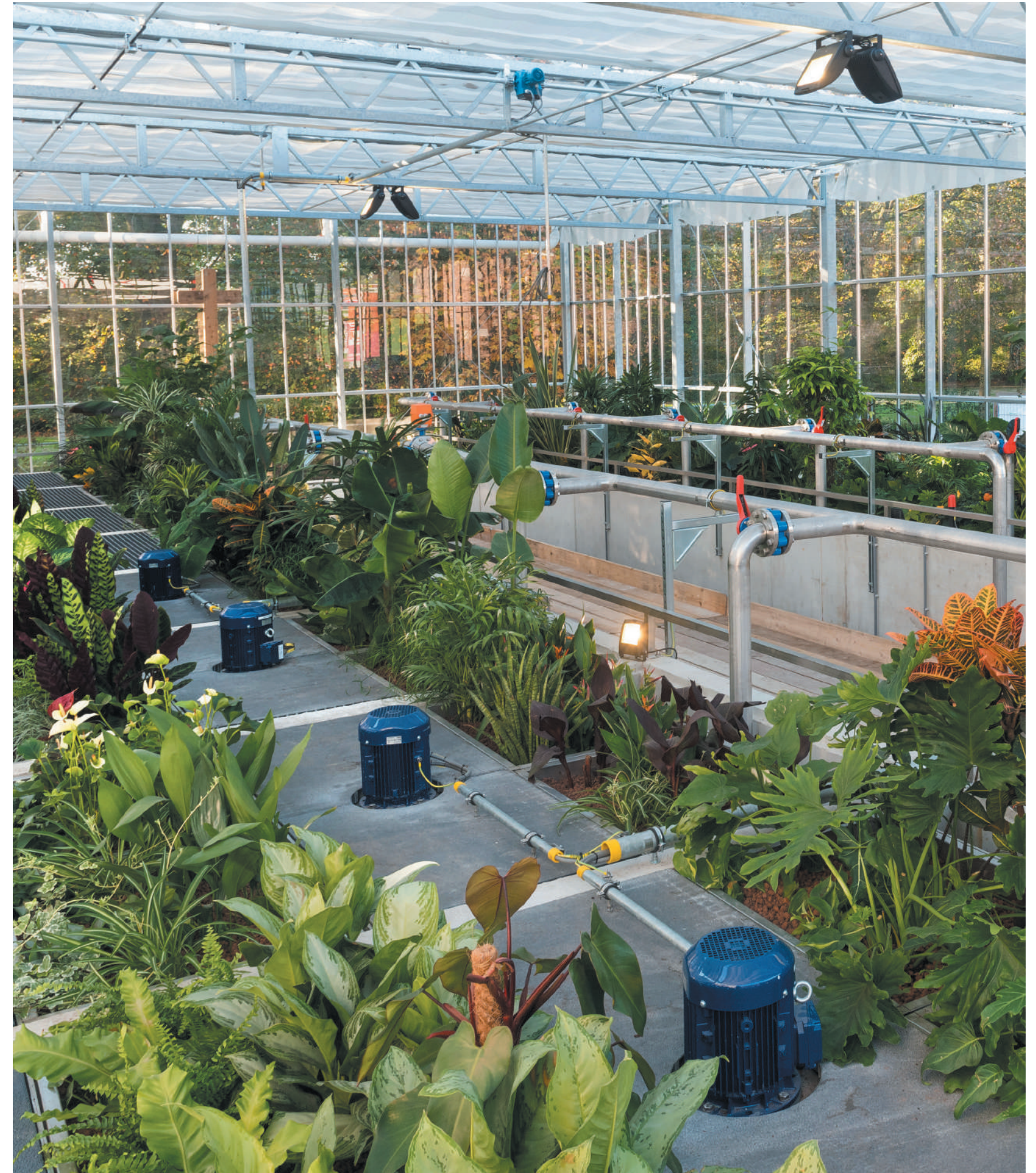
De eerste biomakerij van Nederland bij Adbij OLV Koningshoeven zuivert het huishoudelijk afvalwater en het afvalwater afkomstig van de bierbrouwerij. Hoppenbrouwers verzorgde de aanleg van alle elektra, verlichting, beveiliging, warmtepompen én zonnepanelen
